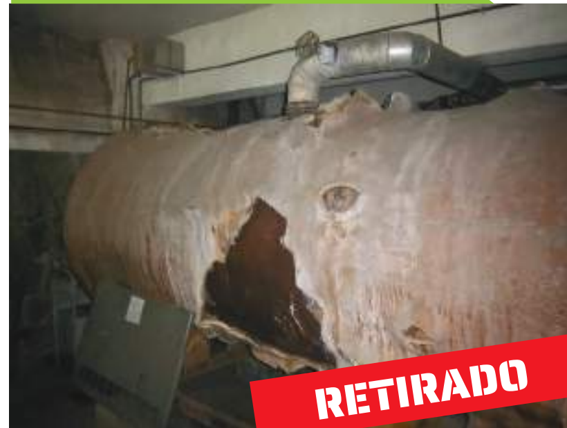
Caldera, Hospital de Salta
